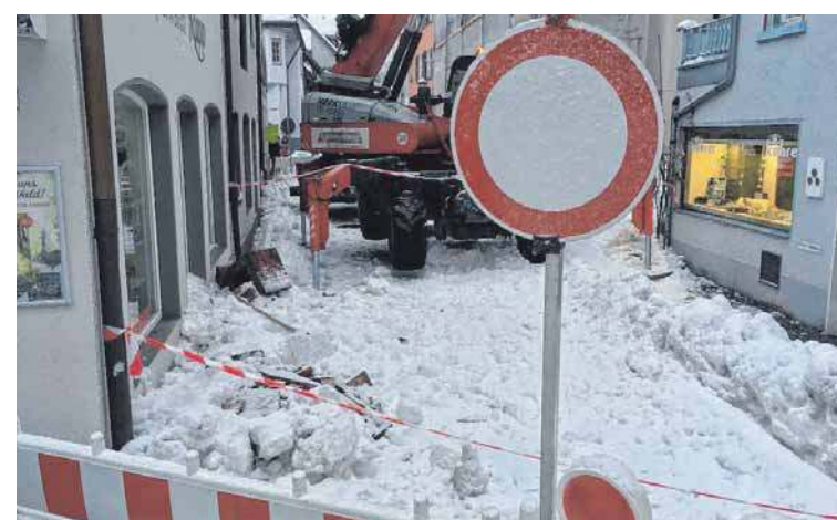
Nach dem Kaminsturz (links) in der Braugasse liefen am Mittwochnachmittag die Sicherungs- und Aufräumarbeiten. FOTO: STEPPAT
